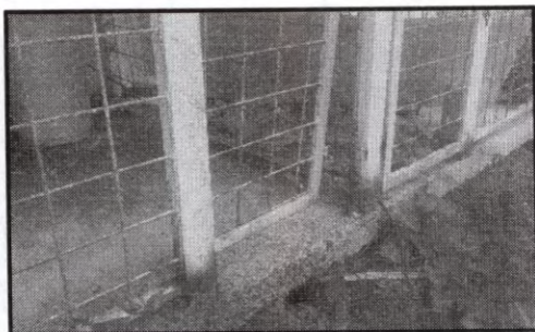
Antes desoldada la puerta
